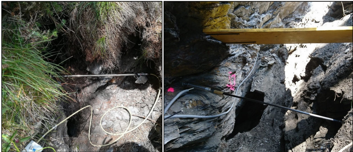
Abbildung 5: Fissurometer und Konvergenzextensometer
