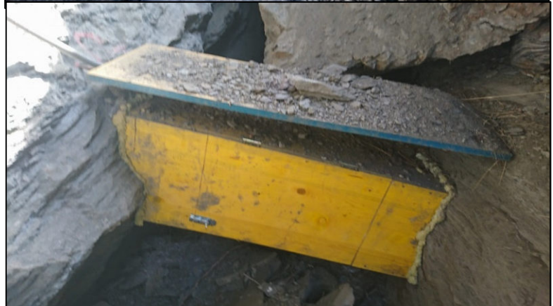
Abbildung 8: Einhausung der Konvergenzextensometer durch die WLVB (Sommer 2019)
